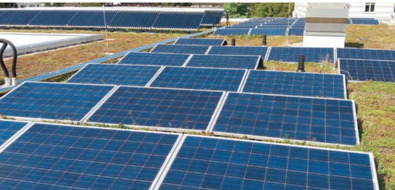
Photovoltaik und Dachbegrünung auf dem Dach der Schule Schendingen in Bregenz © Landeshauptstadt Bregenz
