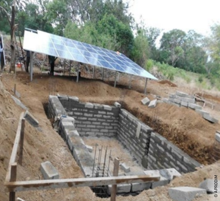
Errichtung eines Hauses für die Steuerungseinheit und die Elektrik der Photovoltaikanlage im Dorf Ojoche de Agua/San Marcos
